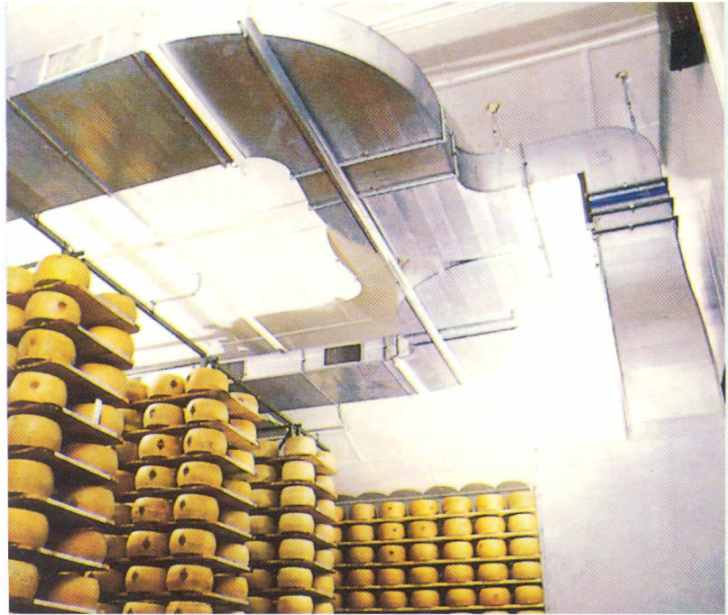
Un impianto per la stagionatura del formaggio Grana (Tecnica del Freddo)
